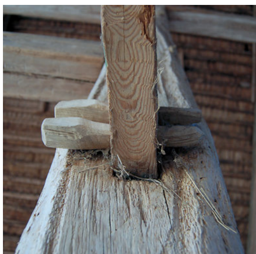
FIGUR IO. (övre bilden) Tapphål för löshult i en stolpe i den östliga högremsvägg med kvarsittande dymling. Alla dymlingar är av ek och formade som en kon med ett mer eller mindre fyrkantigt huvud. De är huggna med yxa, varefter timmermannen använt baksidan av yxan till att slå in dem, alla från samma sida. Detta konstaterande är av betydelse för att förstå tillverkningsprocessen. I stolparna sitter dymlingarna i full längd, man har inte ansett det nödvändigt att såga av dem. Det är möjligt att de är borrarade för så kallat drag, vilket betyder att dymlingshållet i tappen förskjuts några millimeter så att dymlingen under slagningen drar tappens längre in i tapphållet och därvid gör skarven tät. Foto Ulrik Hjort Lassen.
